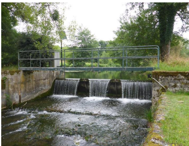
Clapet basculant automatique solaire sur de la Claise
