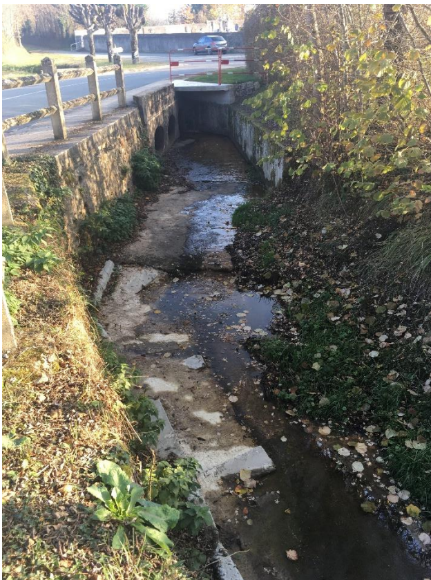
Tronçon aval altéré
