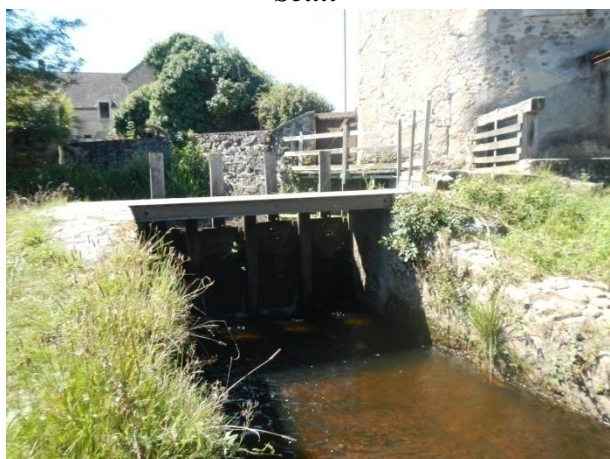
Vannage de décharge
