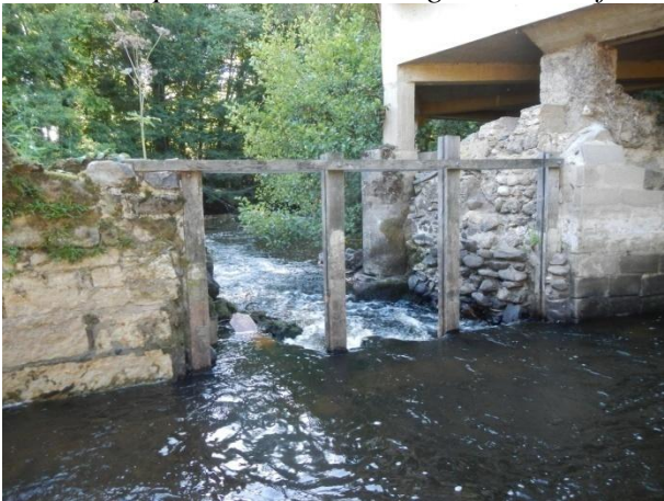
Vannage de décharge ruiné
