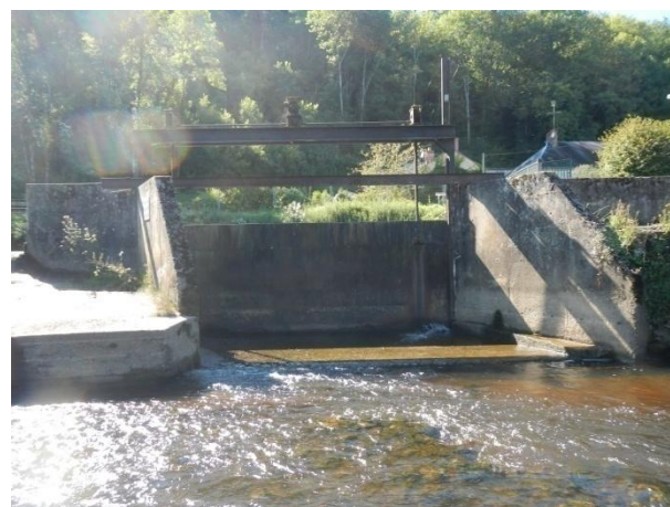
Vanne de décharge principal
