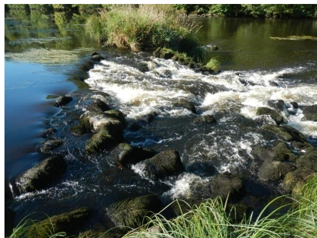
Principale brèche de la chaussée (11 m de large)
