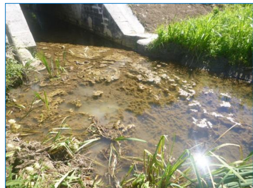
Colmatage du lit
