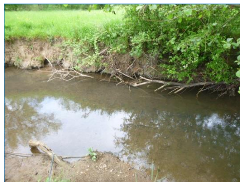
Colmatage du lit sur la Sonne
