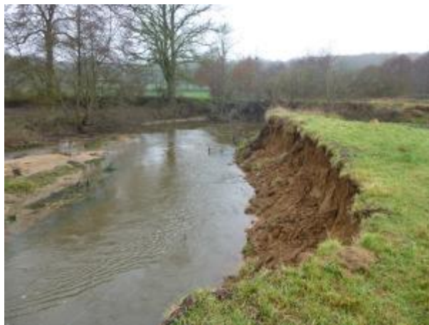
Figure 14 : Forte érosion des berges à Bas Vouhet
