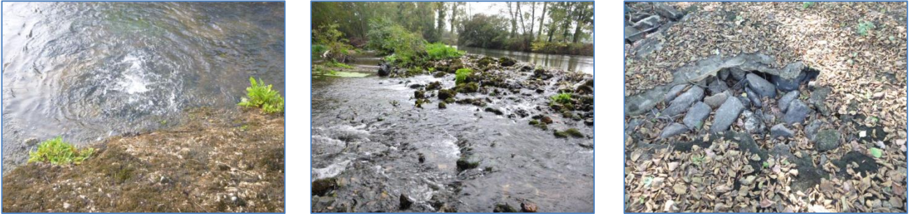
Exemples d'ouvrages plus dégradés à Chavigny, Salleron ou encore Charneuil.
